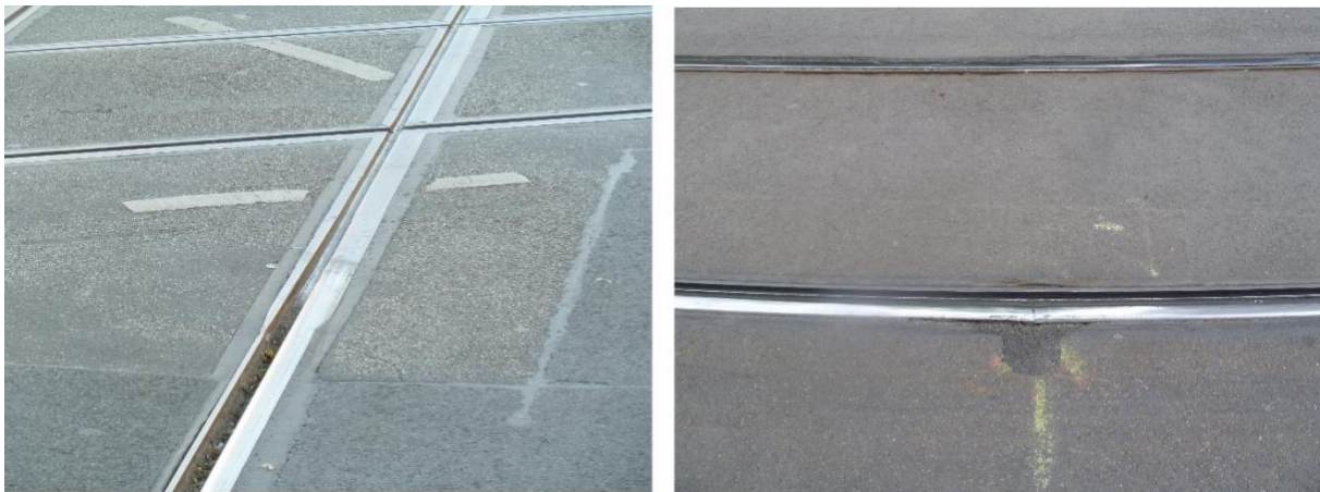
Abbildung 31: Beispiel für einen Kreuzungspunkt mit Rillenschienen und eine Stoßstelle aufgrund eines Schienenbruchs
