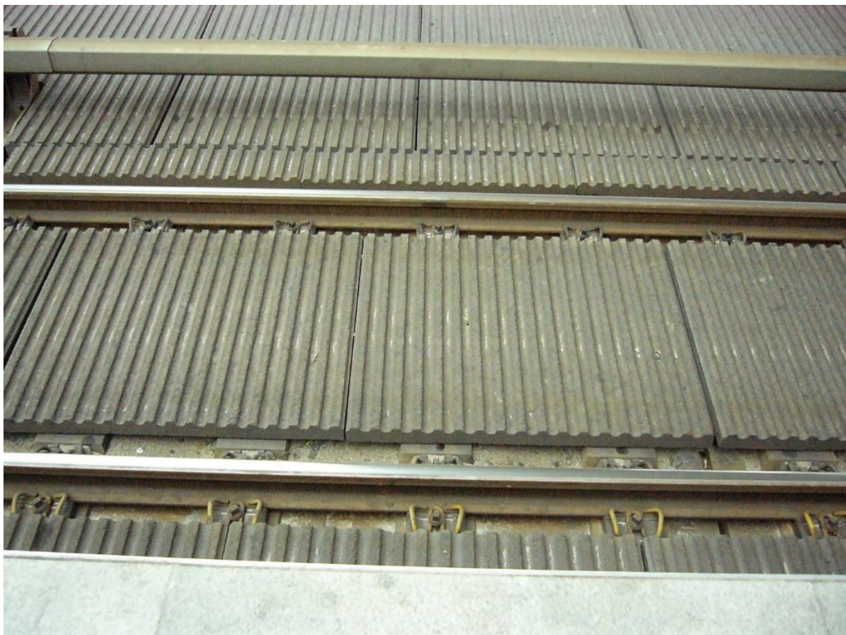
Abbildung 60: Absorberplatten im Gleis zur Minderung der Luftschallemissionen – Beispiel S-Bahn Berlin
