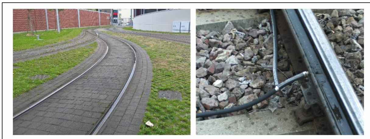
Abbildung 58: Bewässerung der Rillenschienen – Beispiel Karlsruhe
