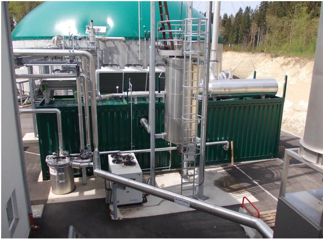
Abbildung 70: BHKW-Container mit Aktivkohle-Adsorber, im Hintergrund der abgedeckte Lagertank für das flüssige Gärgut
