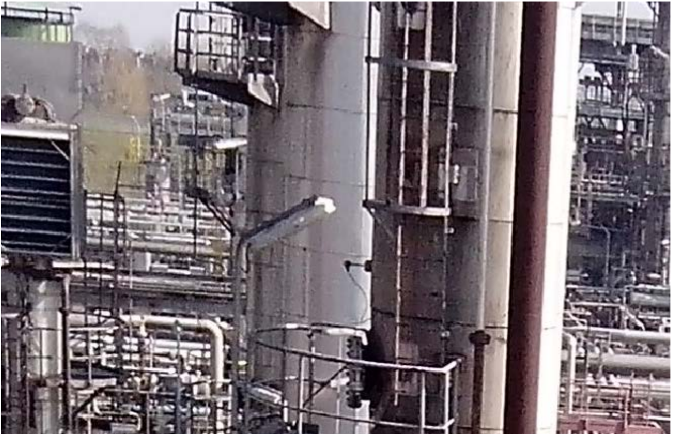
Abbildung 142: Temperaturmessung an der benachbarten Extraktionskolonne
