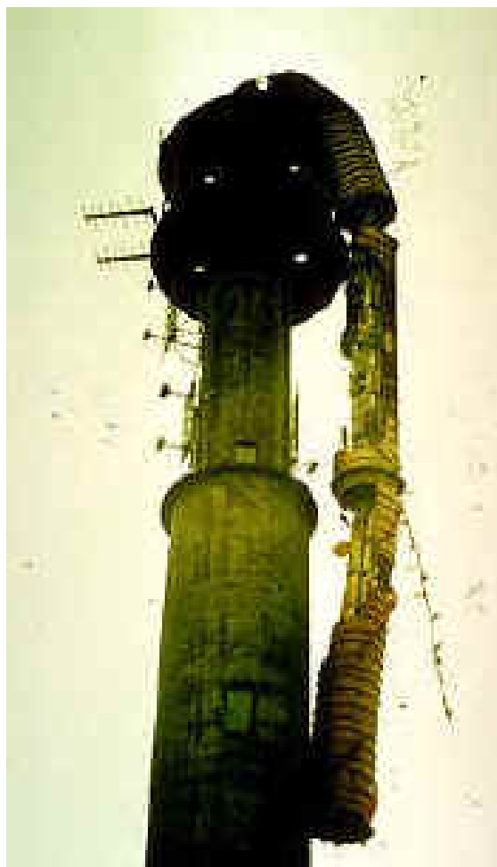
Abbildung 53: Tragwerksversagen des Fernsehturms „Hoher Bogen“ infolge Ermüdung aus wirbelerregten Querschwingungen
