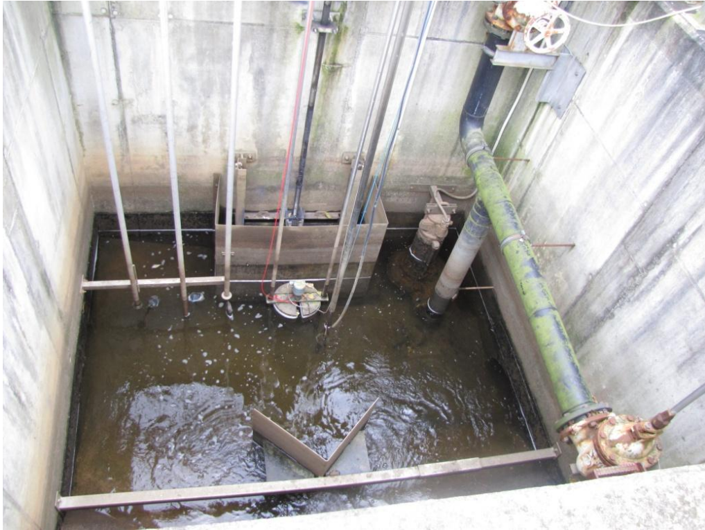
Anhang 6, Abb. 5: Sammelschacht vor der Einleitungsstelle K2 mit fernbedienbarer Verschlusseinrichtung und Messsonden für pH-Wert und Temperatur
