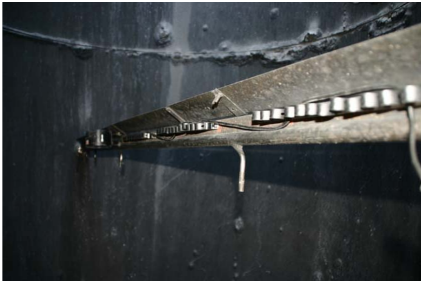
Abb. 1: Probeentnahmeeinrichtung im Abwetterbauwerk der Schachtanlage Asse II
